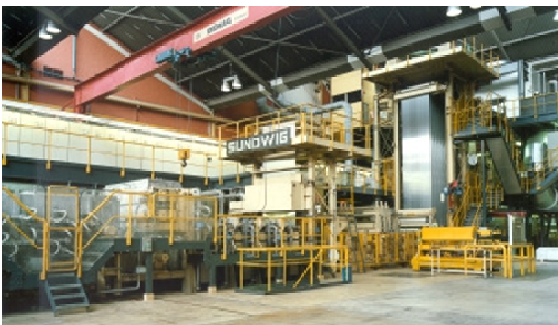
Veredelungsanlage für Aluminiumband, Deutschland
